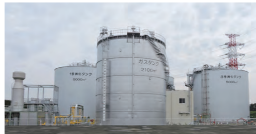
▲消化タンク・ガスタンク
