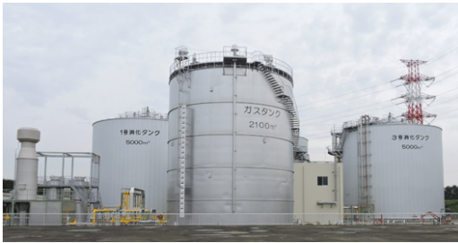
▲消化タンク・ガスタンク
